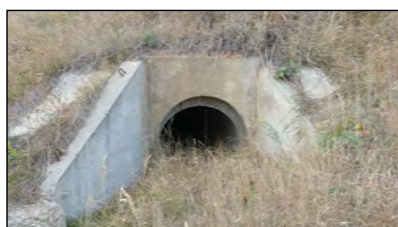
Фото 9. Оголовок на выходе.
