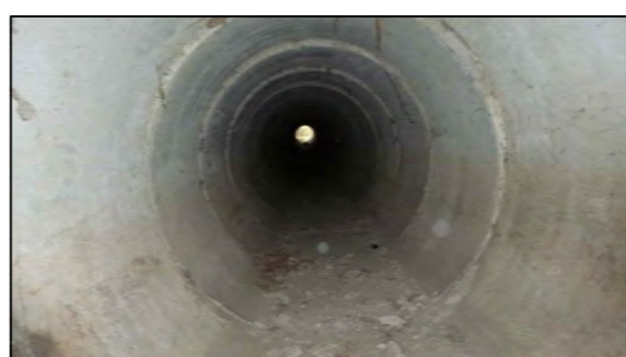
Фото 14. Состояние звеньев и швов внутри трубы.
