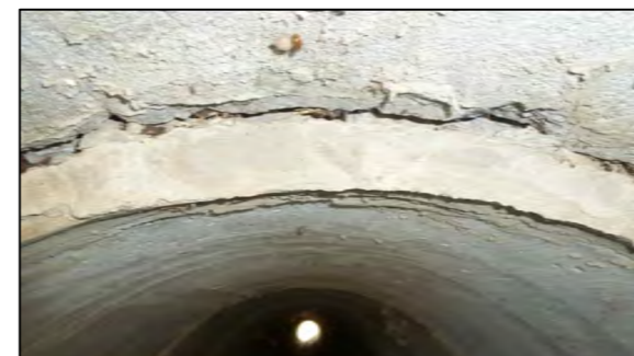
Фото 3. Смещение звена оголовка трубы на входе.
