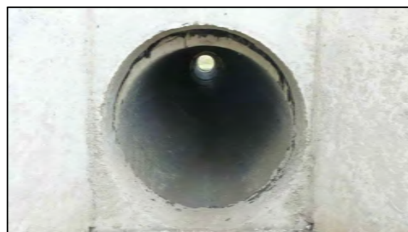
Фото 13. Смещение звена оголовка трубы на выходе.
