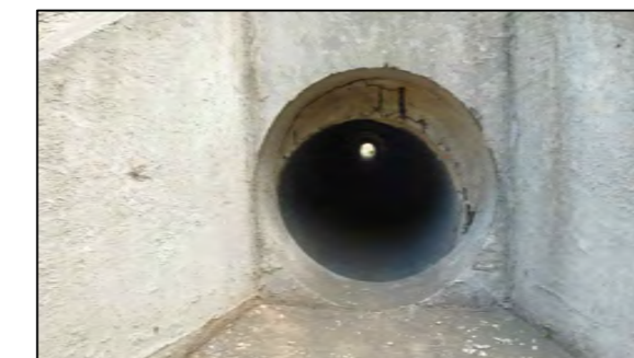
Фото 9. Состояние оголовка и откосных крыльев на выходе.
