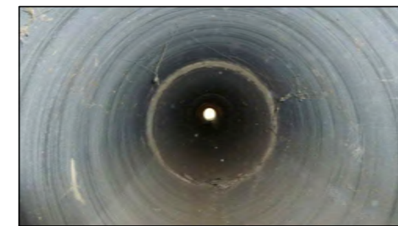
Фото 12. Состояние звеньев внутри трубы.
