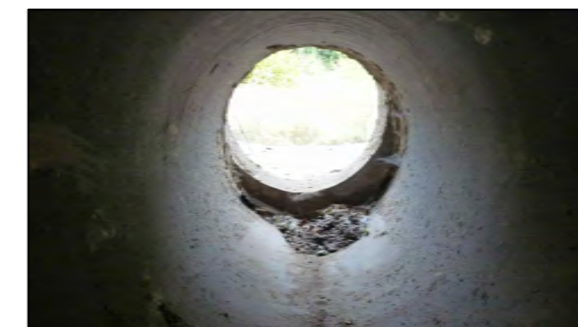
Фото 13. Состояние звеньев внутри трубы.
