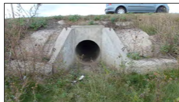
Фото 8. Оголовок на выходе.
