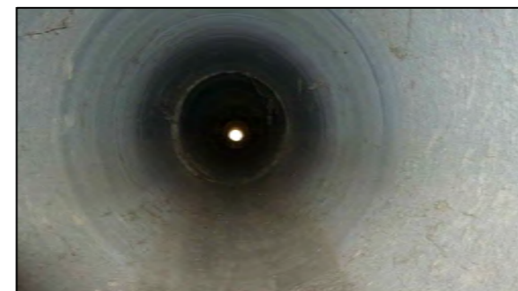
Фото 4. Состояние звеньев внутри трубы.
