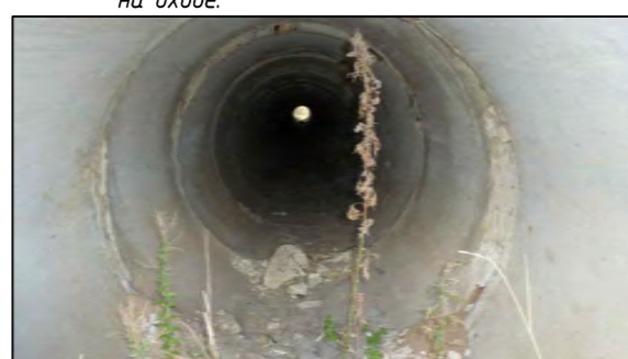
Фото 10. Состояние звеньев и швов внутри трубы.
