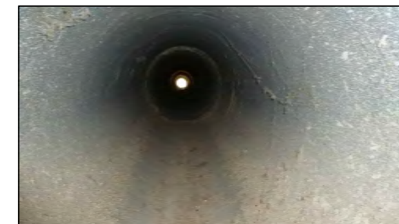
Фото 7. Состояние звеньев внутри трубы.
