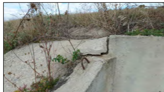
Фото 3. Состояние оголовка и откосных крыльев на входе.
