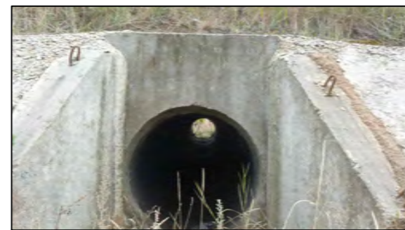
Фото 2. Состояние оголовка и откосных крыльев на входе.
