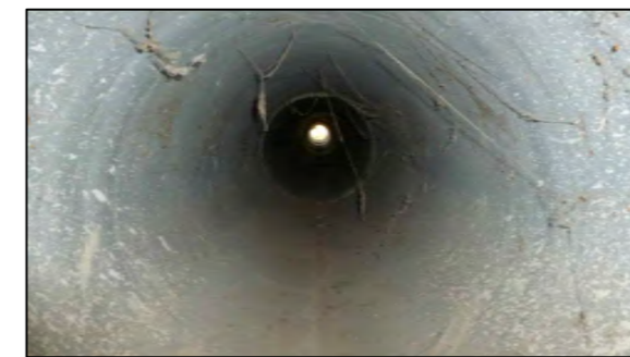
Фото 5. Состояние звеньев внутри трубы.
