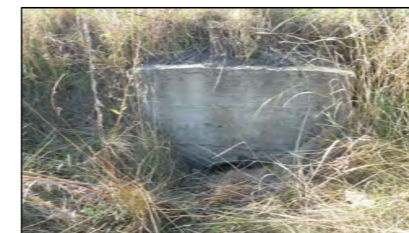
Фото 5. Оголовок на выходе.
