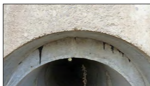
Фото 11. Смещение звена оголовка трубы на выходе.
