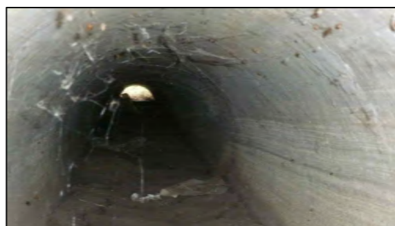
Фото 4. Состояние звеньев внутри трубы.
