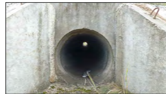
Фото 3. Состояние оголовка и откосных крыльев на входе.
