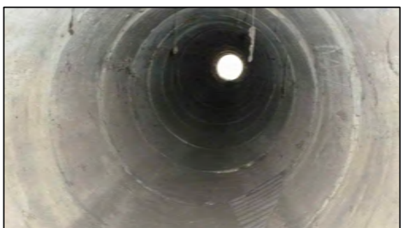
Фото 12. Состояние звеньев внутри трубы.
