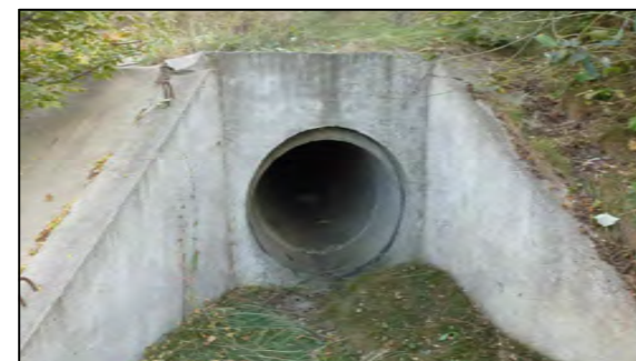
Фото 2. Состояние оголовка и откосных крыльев на входе.
