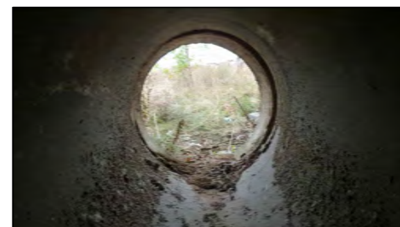
Фото 11. Состояние звеньев внутри трубы.
