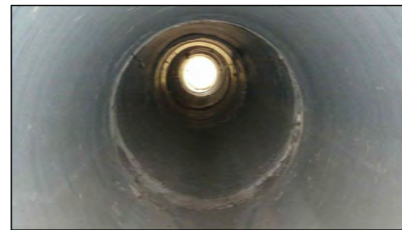
Фото 3. Состояние звеньев и швов внутри трубы.
