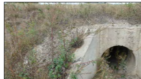
Фото 2. Состояние откосных крыльев, оголовка и укрепления откоса на входе.
