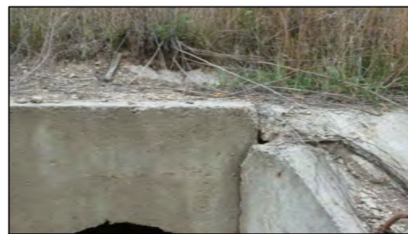
Фото 8. Состояние оголовка откосных крыльев на выходе.
