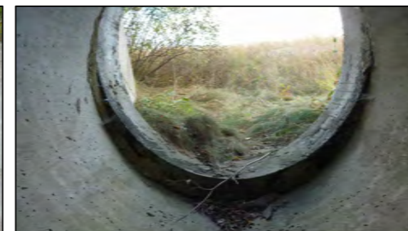
Фото 5. Смещение звена оголовка трубы на входе.
