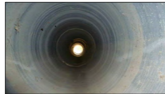
Фото 4. Состояние звеньев внутри трубы.
