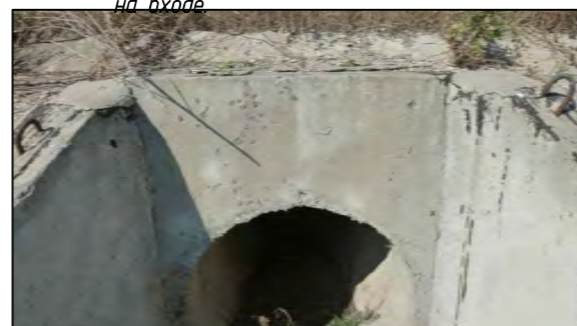
Фото 9. Состояние оголовка и откосных крыльев на выходе.
