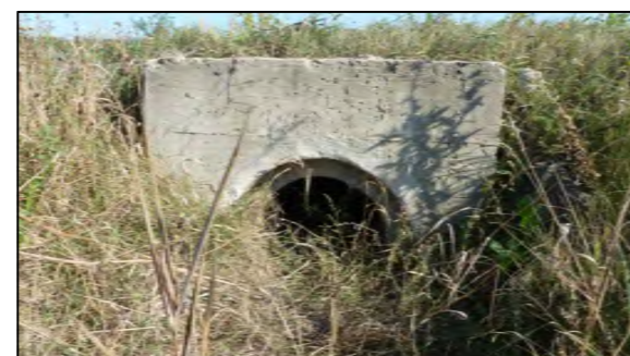
Фото 2. Состояние оголовка на входе.
