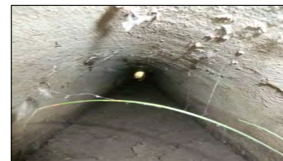
Фото 6. Состояние звеньев внутри трубы.
