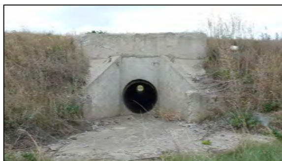
Фото 9. Оголовок на выходе.
