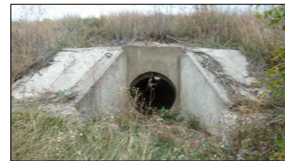
Фото 7. Оголовок на выходе.
