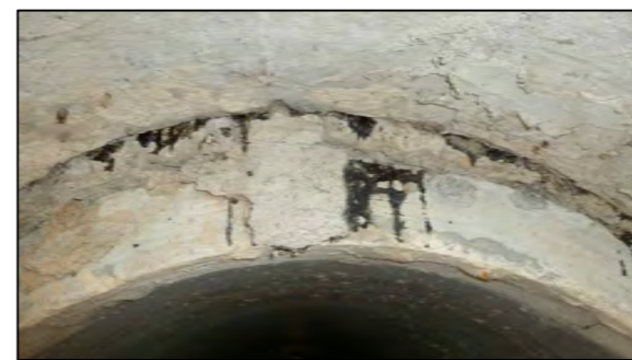
Фото 11. Смещение звена оголовка трубы на выходе.
