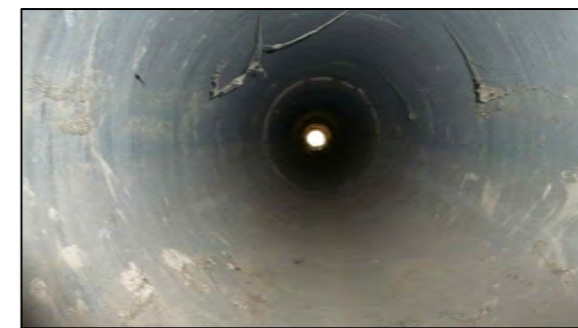
Фото 14. Состояние звеньев внутри трубы.
