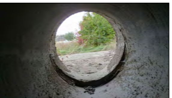
Фото 15. Состояние звеньев внутри трубы.
