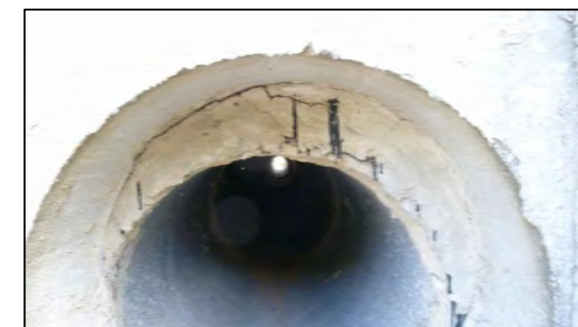
Фото 12. Смещение звена оголовка трубы на выходе.
