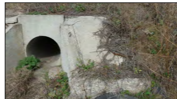
Фото 5. Состояние оголовка и укрепления откоса на входе.
