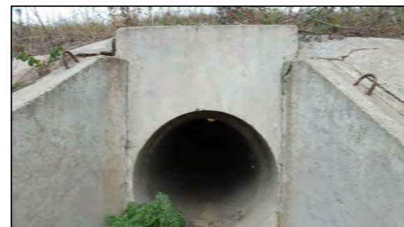
Фото 2. Состояние оголовка и откосных крыльев на входе.
