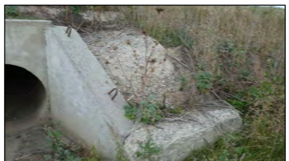
Фото 10. Состояние откосных крыльев и укрепления откоса на выходе.
