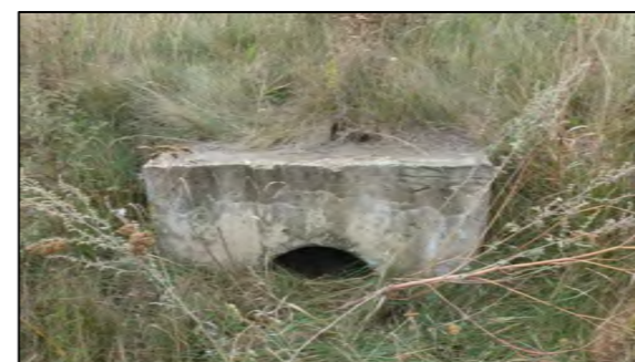
Фото 5. Оголовок на выходе.
