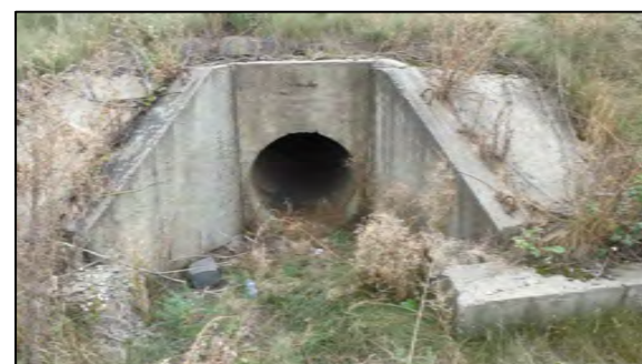
Фото 8. Оголовок на выходе.
