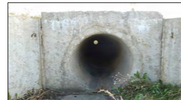
Фото 2. Состояние оголовка и откосных крыльев на входе.
