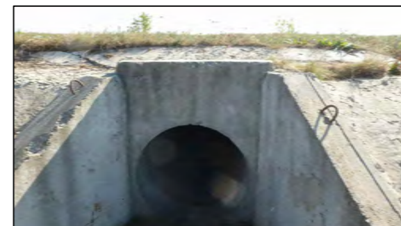
Фото 2. Состояние оголовка и откосных крыльев на входе.
