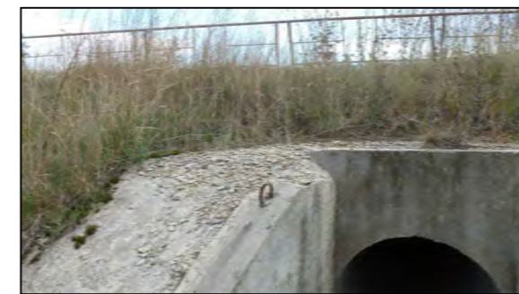
Фото 4. Состояние оголовка и укрепления откоса на входе.
