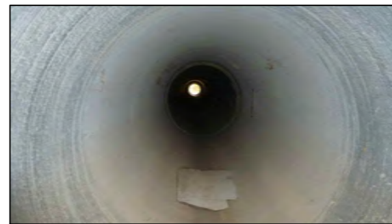
Фото 2. Состояние звеньев внутри трубы.
