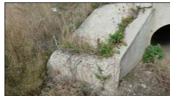
Фото 4. Состояние оголовка и укрепления откоса на входе.
