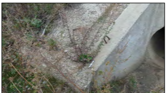
Фото 11. Состояние откосных крыльев и укрепления откоса на выходе.
