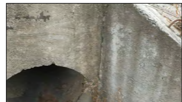
Фото 10. Состояние оголовка и откосных крыльев на выходе.
