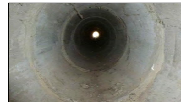
Фото 5. Состояние звеньев и швов внутри трубы.
