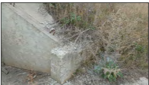
Фото 12. Состояние откосных крыльев и укрепления откоса на выходе.
