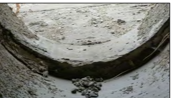
Фото 14. Смещение звена оголовка трубы на выходе.
