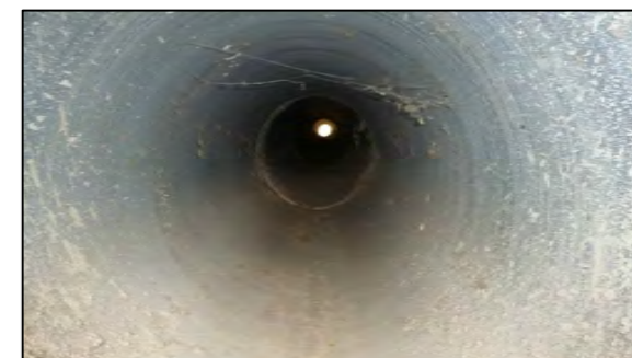
Фото 14. Состояние звеньев внутри трубы.
