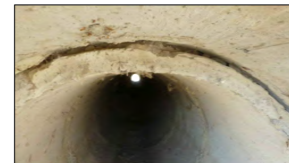
Фото 13. Смещение звена оголовка трубы на выходе.
