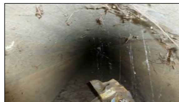
Фото 3. Состояние звеньев внутри трубы.
