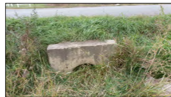
Фото 3. Оголовок на выходе.
