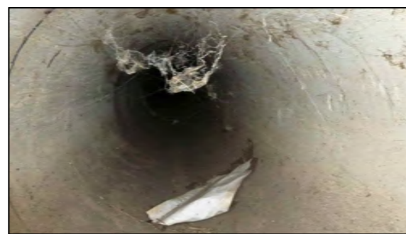
Фото 2. Состояние звеньев внутри трубы.
