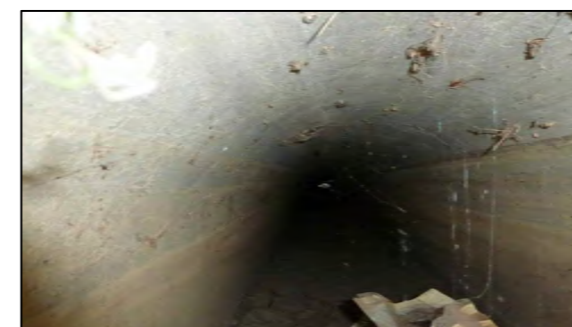
Фото 4. Состояние звеньев внутри трубы.
