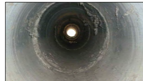
Фото 5. Состояние звеньев внутри трубы.
