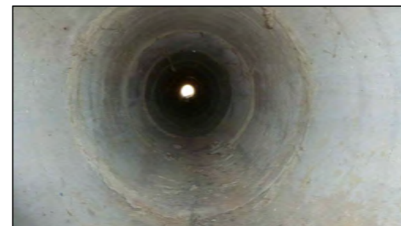
Фото 4. Состояние звеньев и швов внутри трубы.
