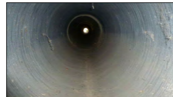
Фото 6. Состояние звеньев внутри трубы.
