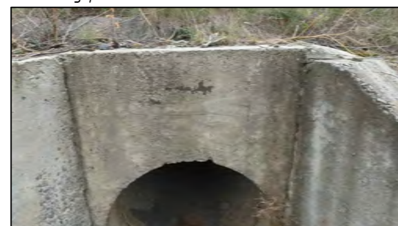
Фото 9. Состояние оголовка и откосных крыльев на выходе.
