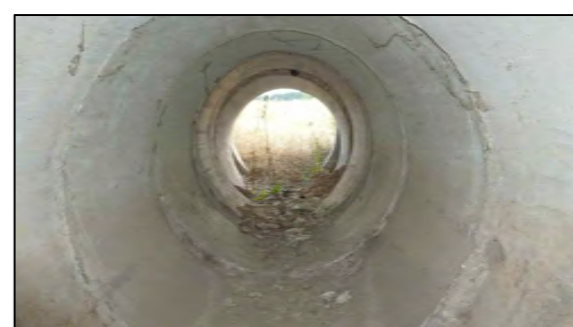
Фото 15. Состояние звеньев и швов внутри трубы.
