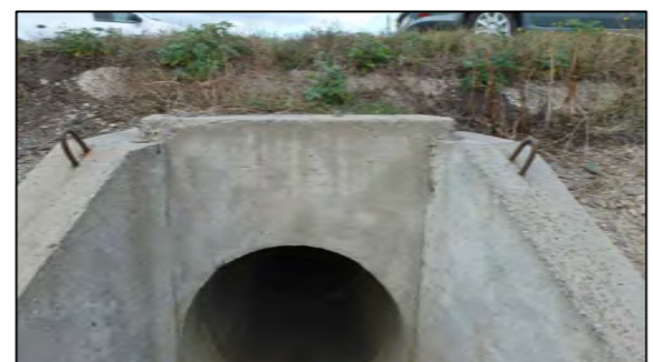
Фото 9. Состояние оголовка и откосных крыльев на выходе.
