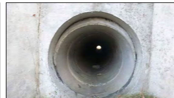
Фото 3. Смещение звена оголовка трубы на входе.
