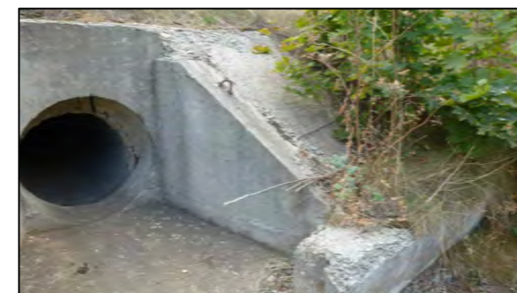
Фото 10. Состояние откосных крыльев и укрепления откоса на выходе.
