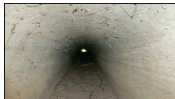
Фото 2. Состояние звеньев внутри трубы.
