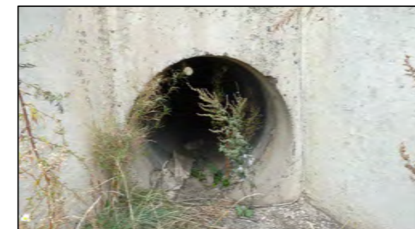
Фото 3. Состояние оголовка и откосных крыльев на входе.
