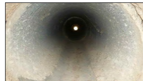
Фото 12. Состояние звеньев внутри трубы.
