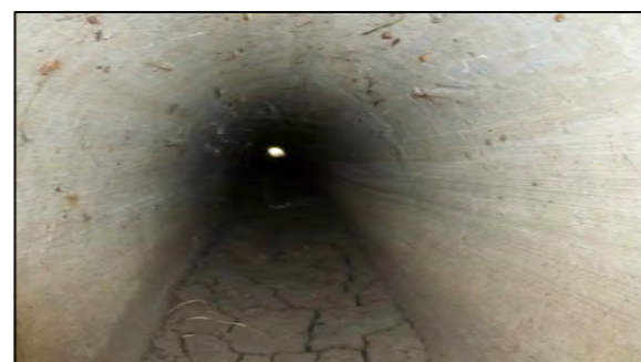
Фото 3. Состояние звеньев внутри трубы.
