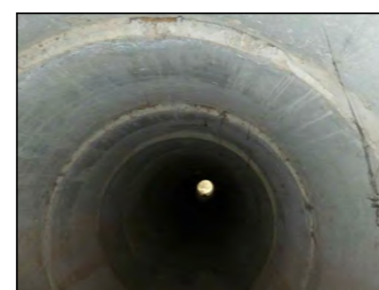
Фото 16. Состояние звеньев и швов внутри трубы.
