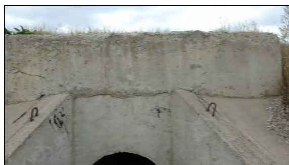
Фото 11. Состояние оголовка и откосных крыльев на выходе.
